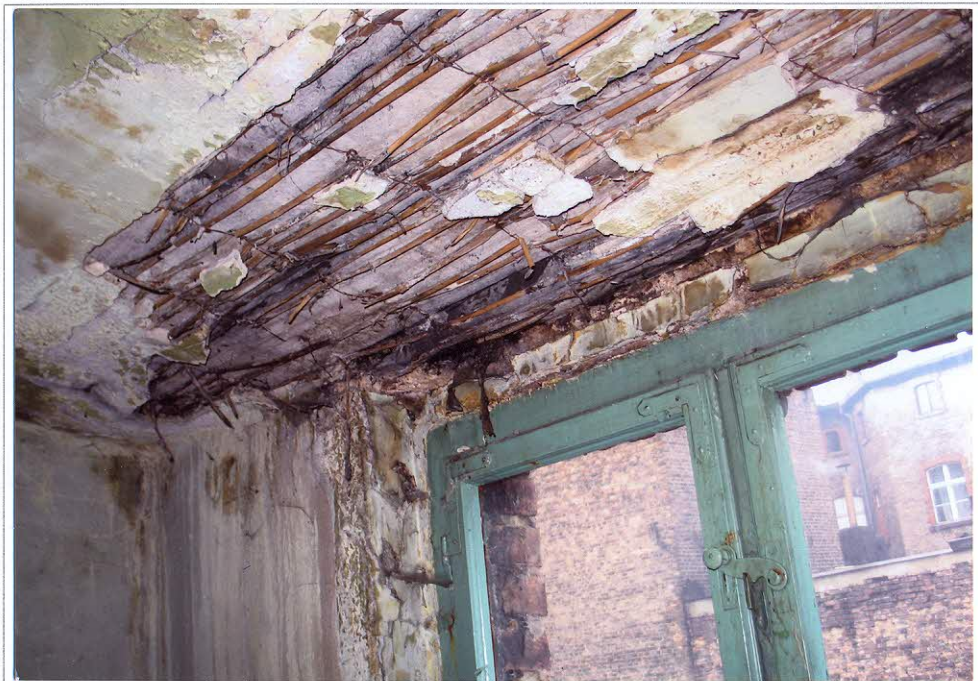
Fot. 19 Zniszczenia w obrębie wykusza
