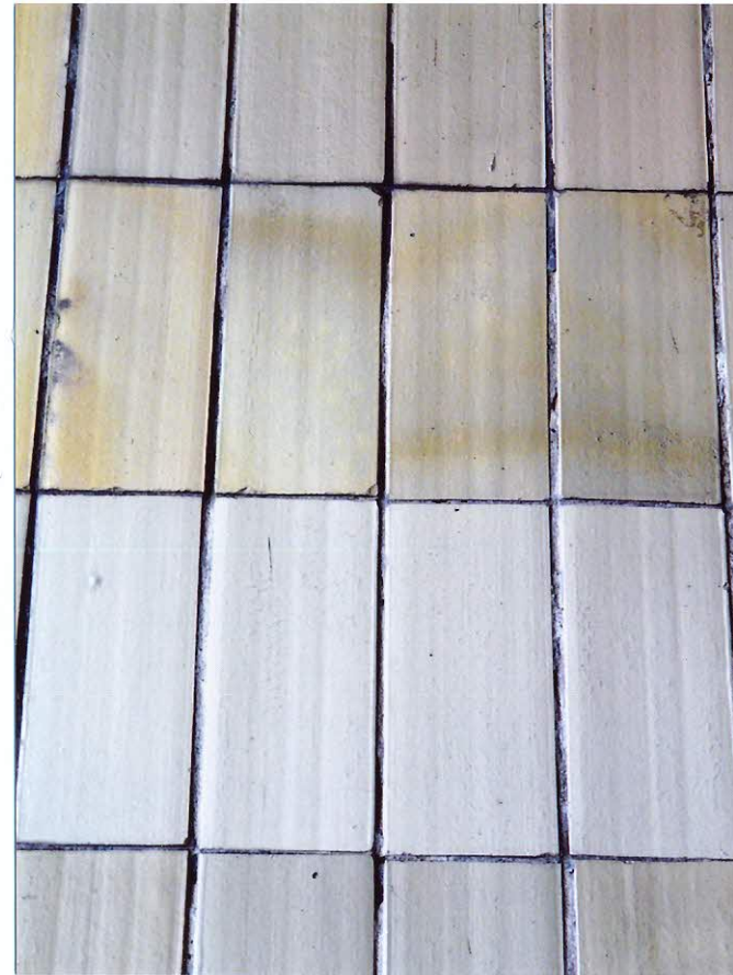
Frag. okładziny ceramicznej ściany przyczółka wiaduktu.
