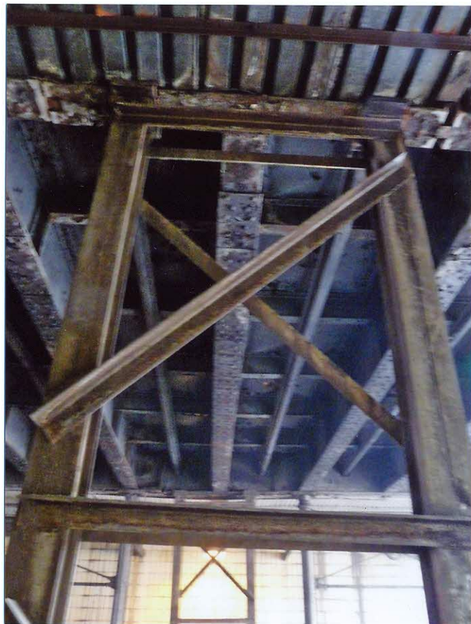
Frag. podpory prowizorycznej.
